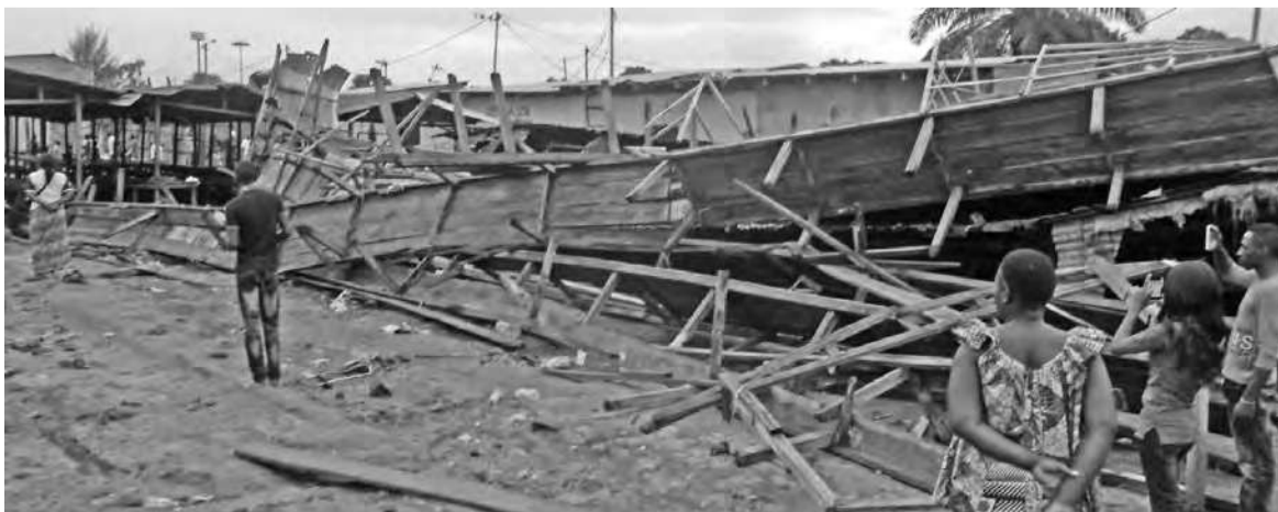
Les étalages sous lesquels la vendeuse est morte
