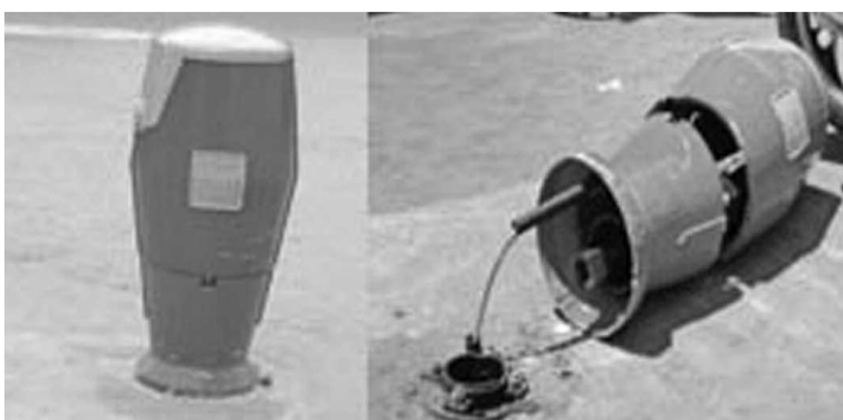
Ne pas saboter les bouches d'incendie
