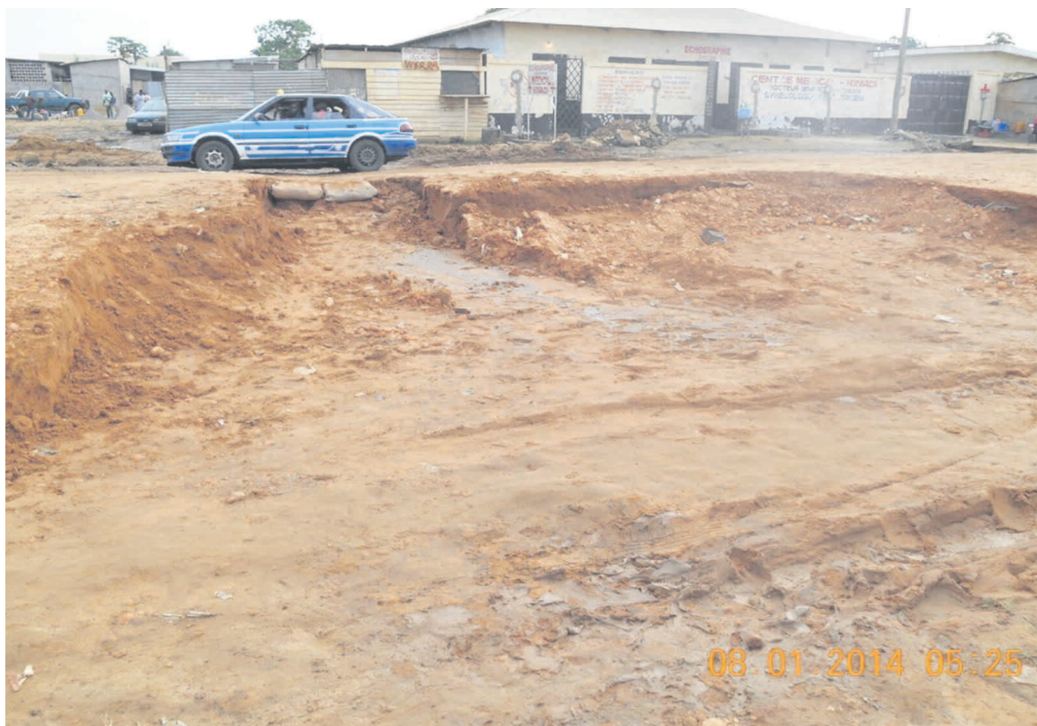
L'avenue Thystère à Mongo Kamba après les pluies Crédit photo "Adiac"
