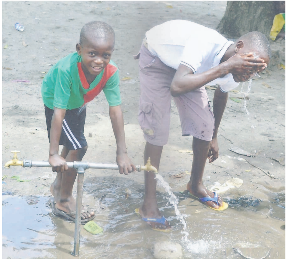
Garantir des installations fiables pour un meilleur accès à l'eau potable en milieu rural
