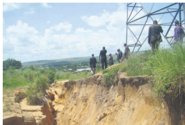
La délégation de la SNE visitant l'érosion de Mayanga qui est à 2m du pylône ; crédit photo Adiac
