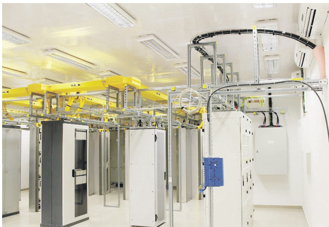
Centre d'atterrage de câble de la fibre optique à Muanda (Bas-Congo)
