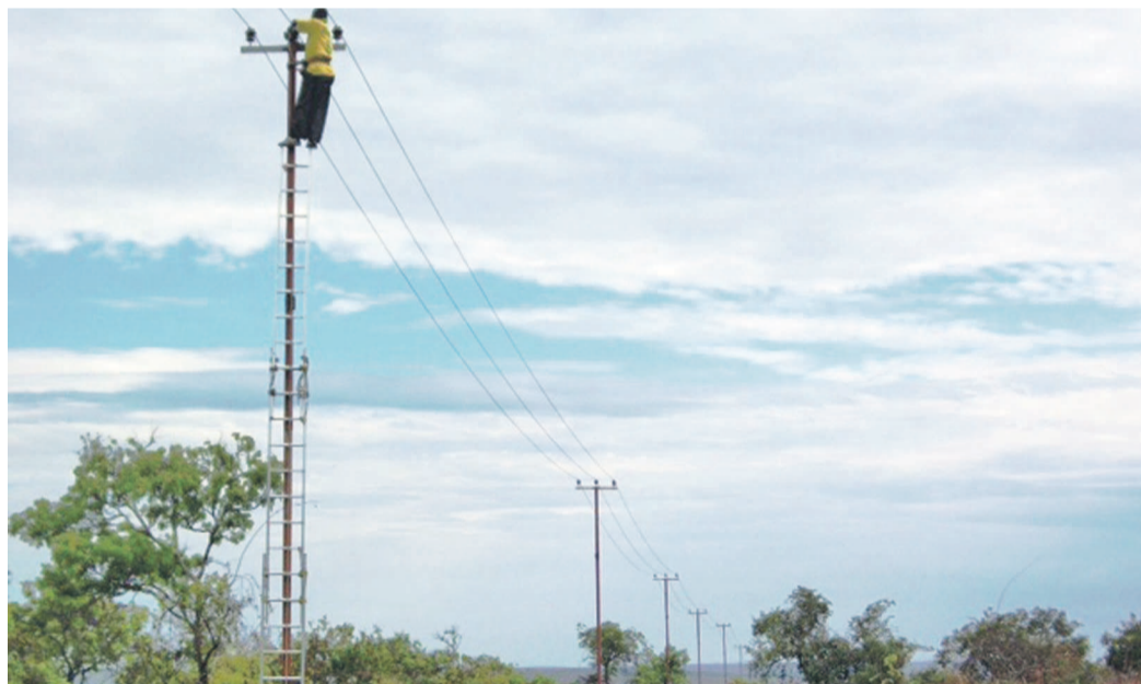
Ligne de transport du courant électrique à 432 Km de la ville de Kinshasa
