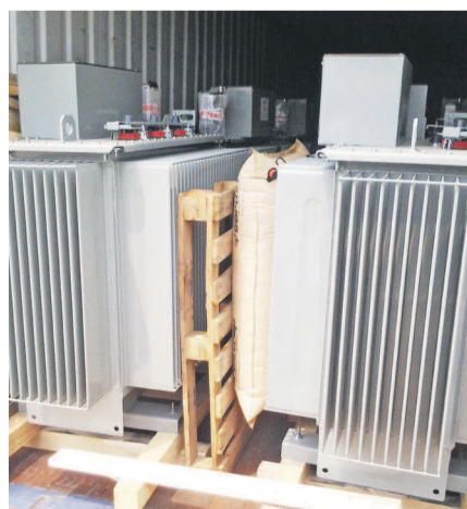
Un échantillon de transformateur
