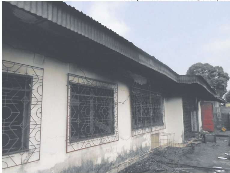
La maison consumée après une fuite au niveau de la cuisinière à gaz
