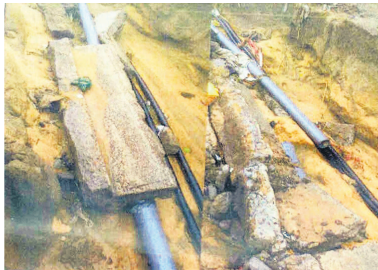
Une vue des dégâts causés par la pluie nettoyé et sécurisé.
