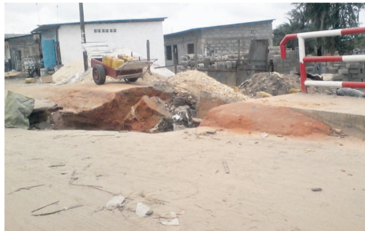
La cassure au niveau du pont sur la Tchiloulou
