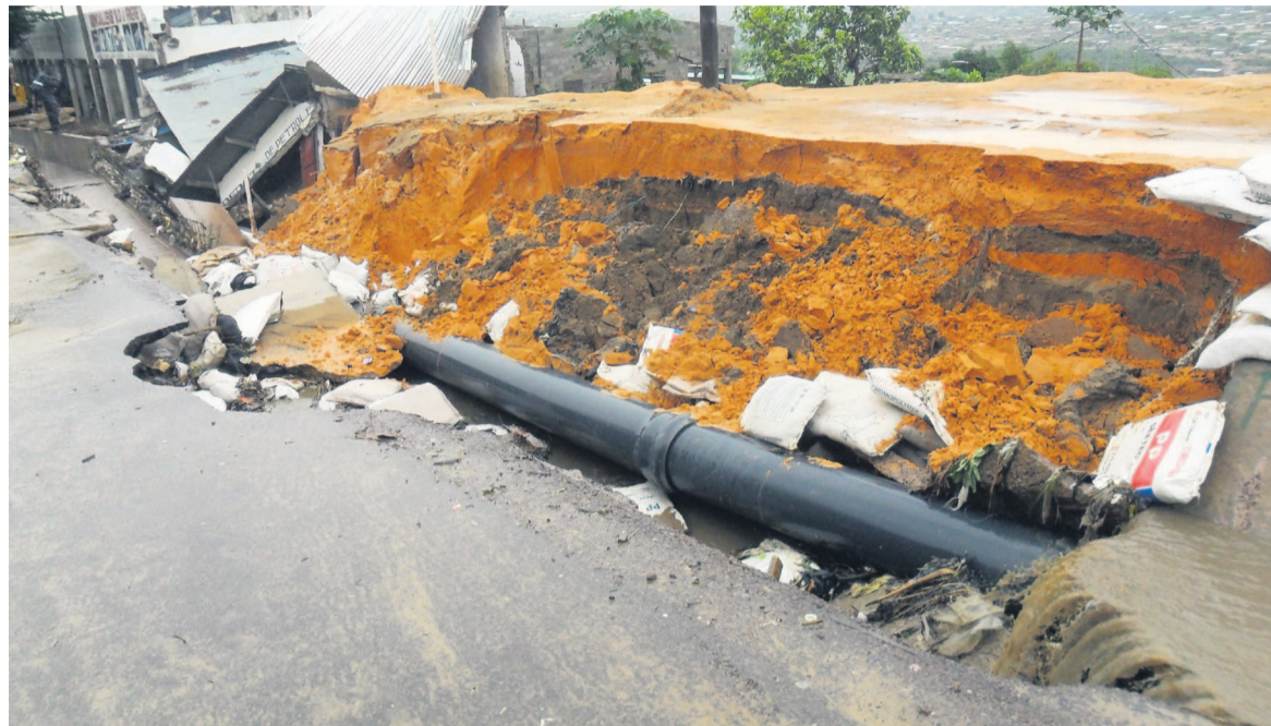
Des dégâts sur la route nationale n°2 à la suite des pluies
