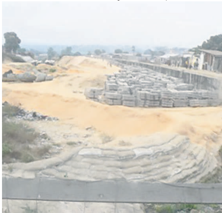
Un cas de traitement d'érosion au quartier Emeraude au nord de Brazzaville (adiac)
