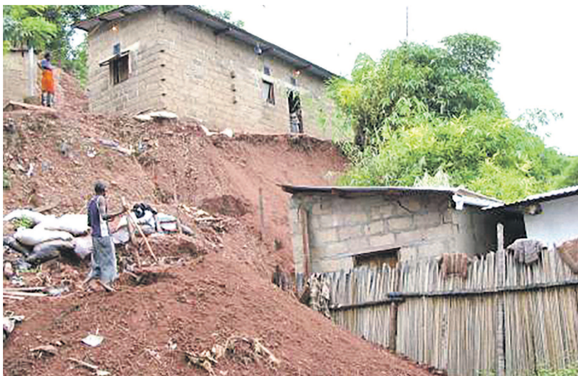
Des glissements de terrain sont fréquents en RDC
