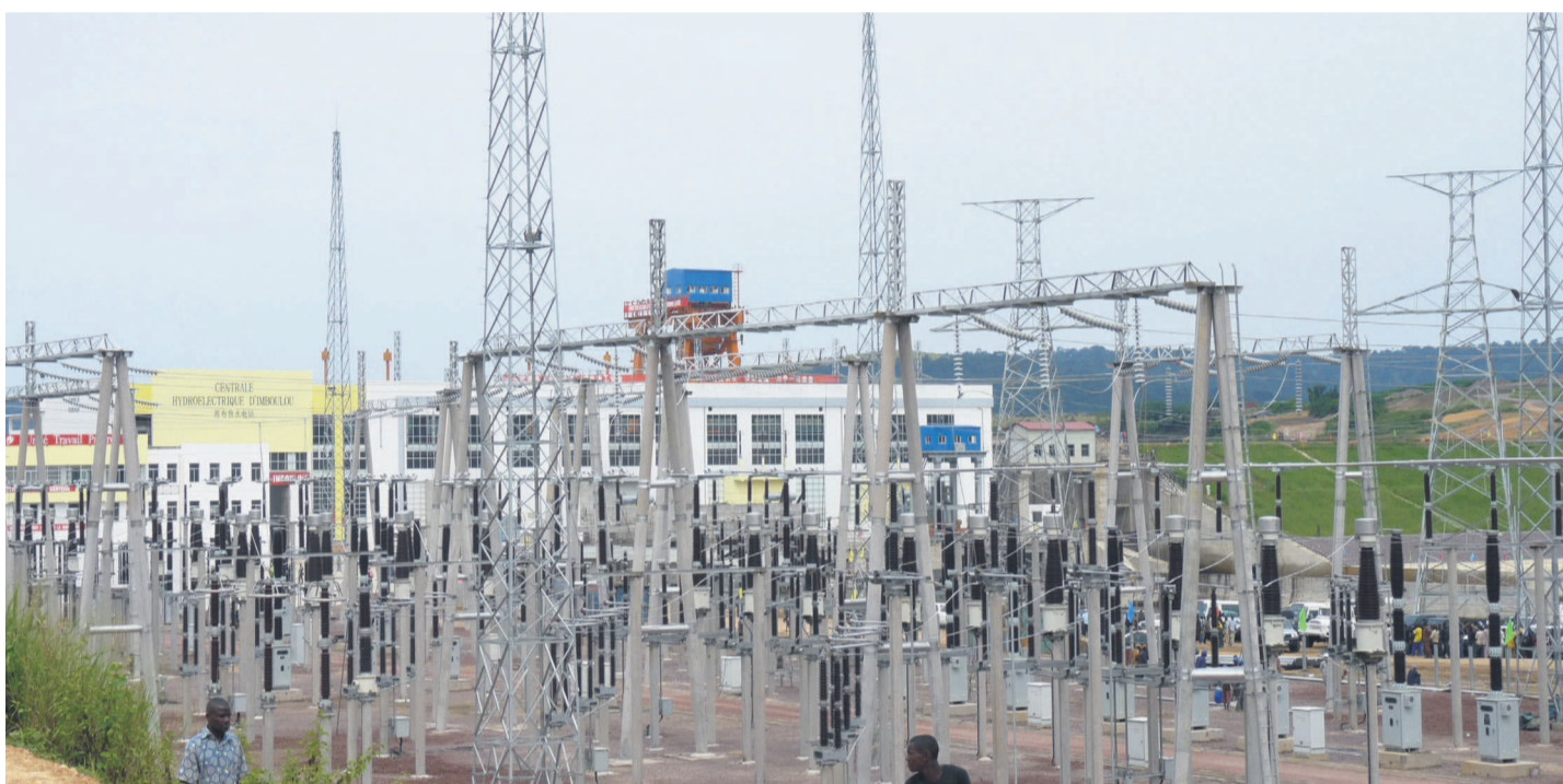
Les installations de la SNE à Imboulou
