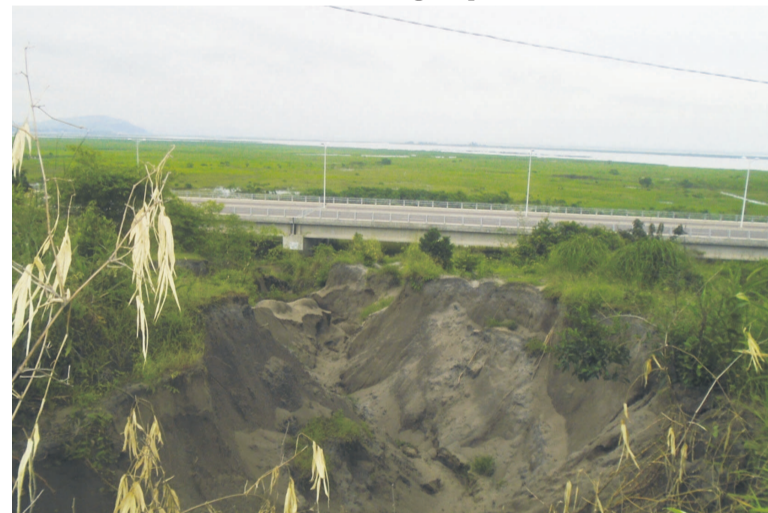
Une vue d'une érosion déclarée à quelques encablures du viaduc/photo Adiac
