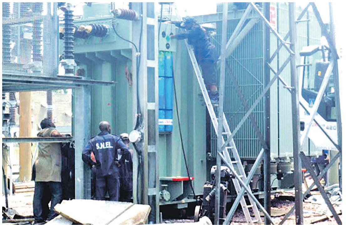
Un transformateur de la Snel à Kinshasa
