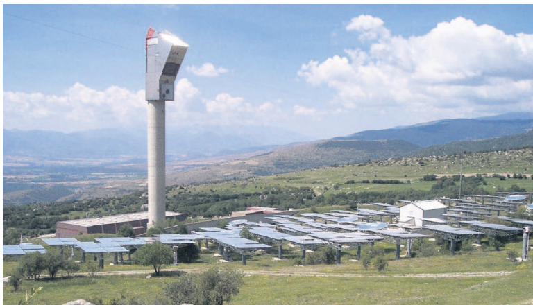
Une centrale solaire (DR)
