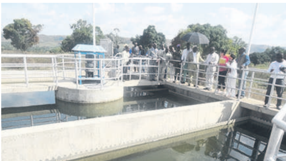
L'usine de traitement d'eau de Mindouli
