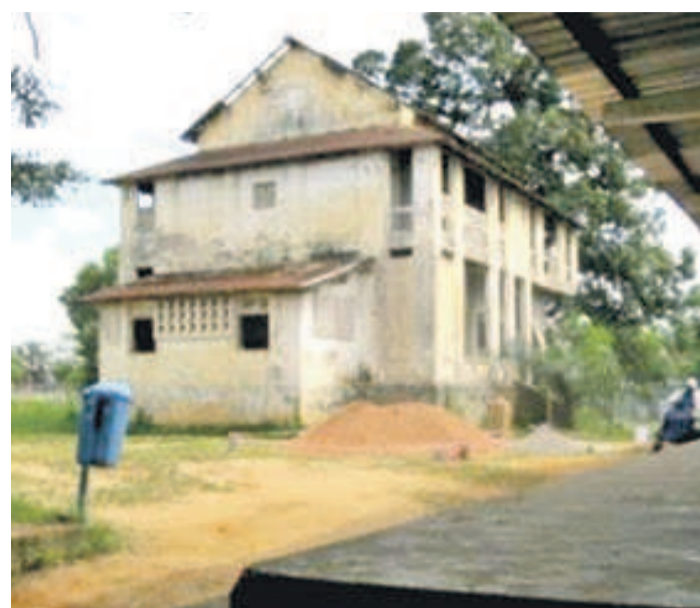
Le bâtiment colonial de l'école primaire Jean-Félix-Tchicaya dans un état de délabrement total/Adiac
