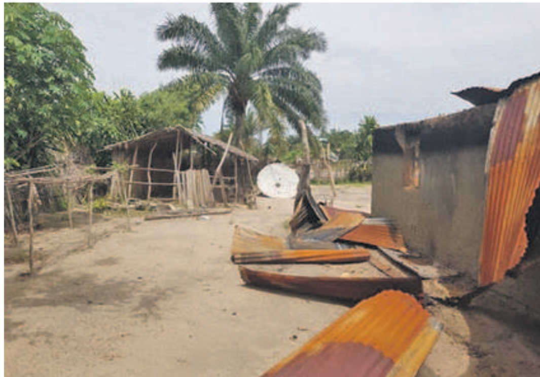
Les habitations ont été détruites à Yumbi
