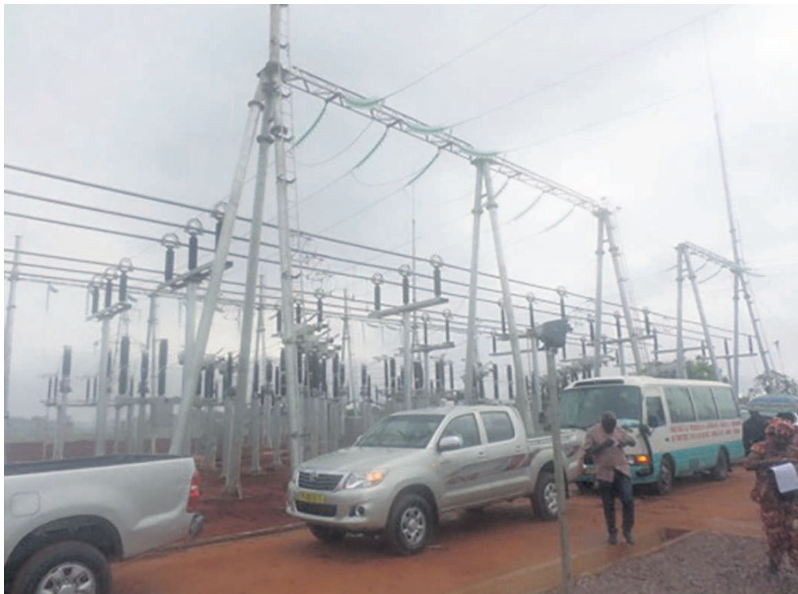
Des installations électriques
