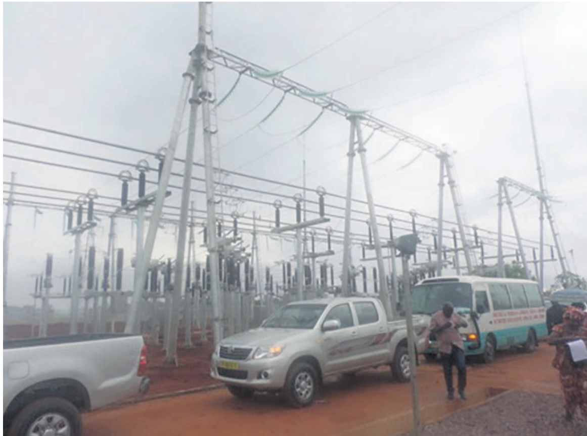
Des installations électriques
