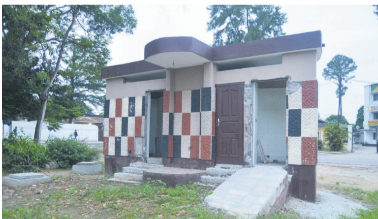
Les toilettes publiques vandalisées vers le stade Marchand
