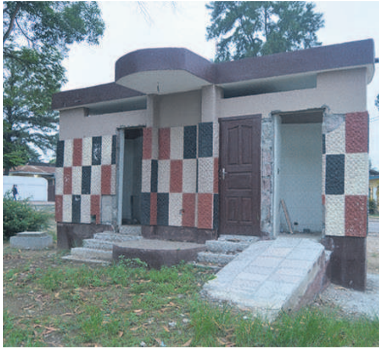
Les toilettes publiques vandalisées vers le stade Marchand
