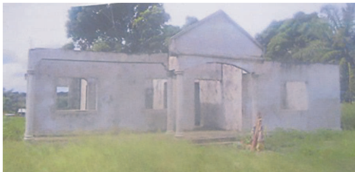
Le logement non achevé du médecin d'Ewo, Cuvette ouest/Adiac
