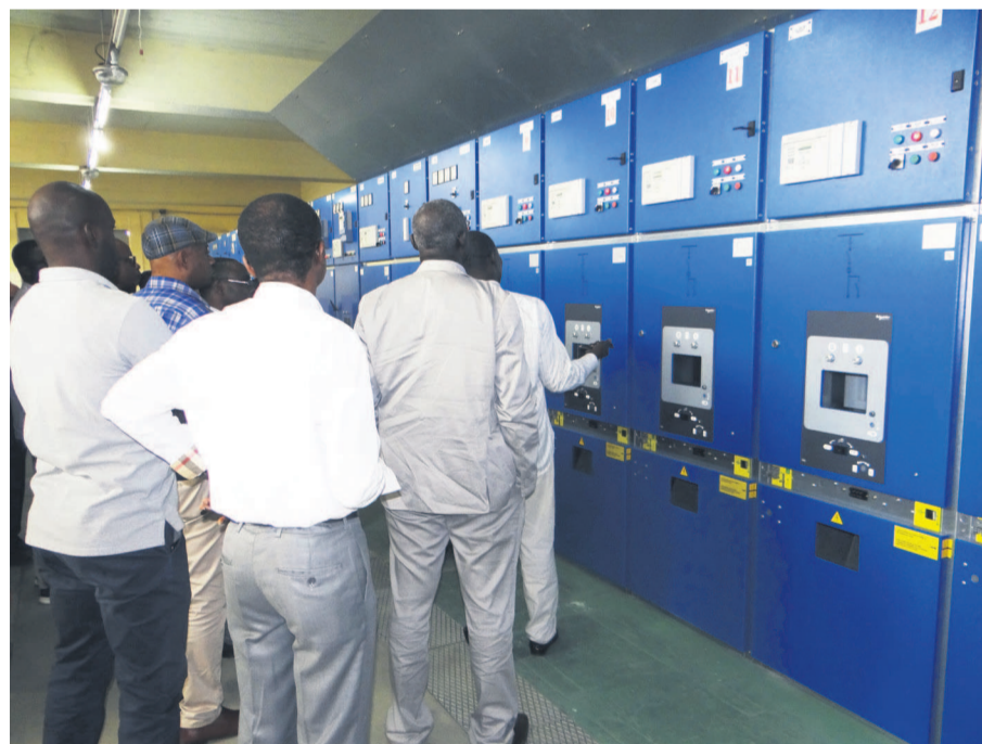
Une vue partielle des cellules PIX installées par le PEEDU au poste-source Tsielampo
