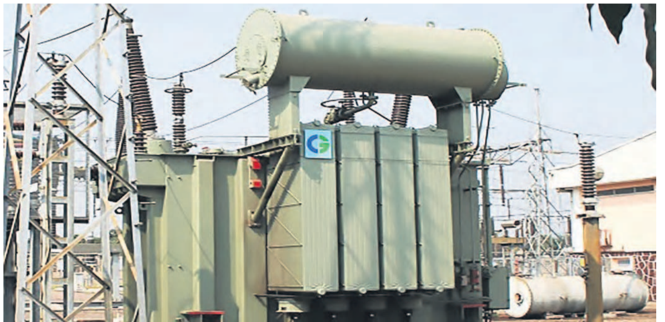
Une cabine électrique de la Snél
