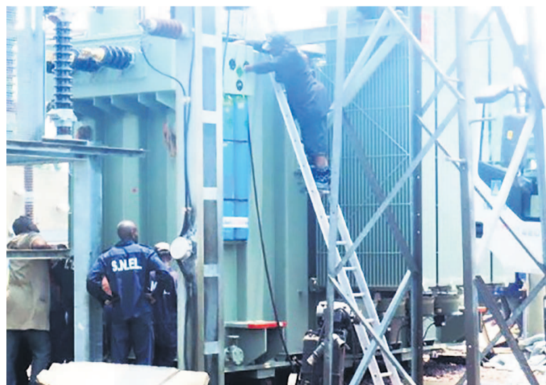
Un transformateur de la Snél à Kinshasa
