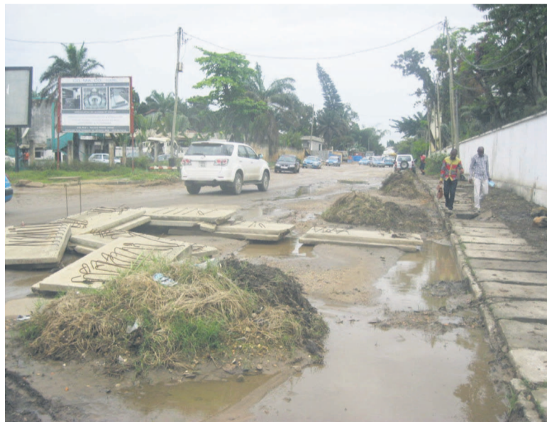
L'état de la route au niveau du rond-point de la CNSS, à l'extrême droite/Adiac
