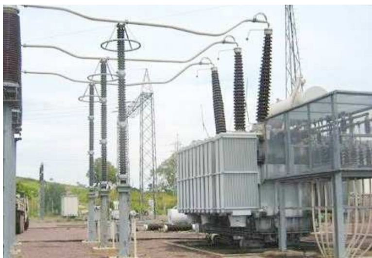
Les installations électriques de la société Énergie électrique du Congo
