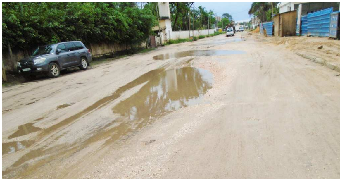
Des nids de poule sur une portion de route/Adiac
