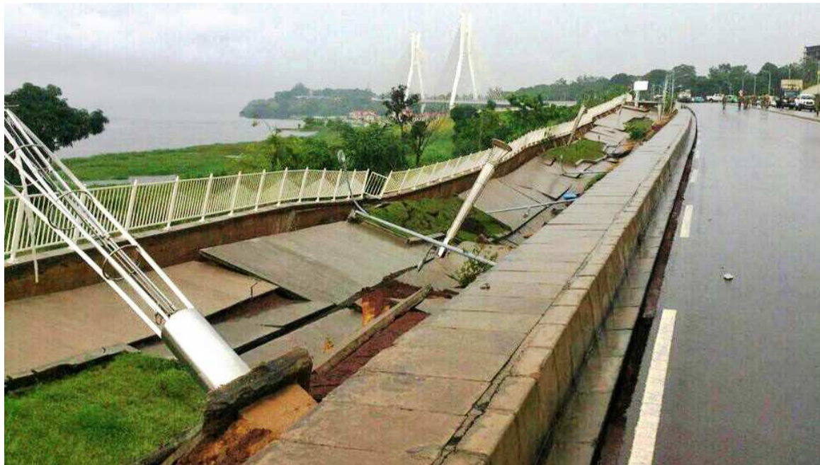
Le trottoir de la corniche effondré
