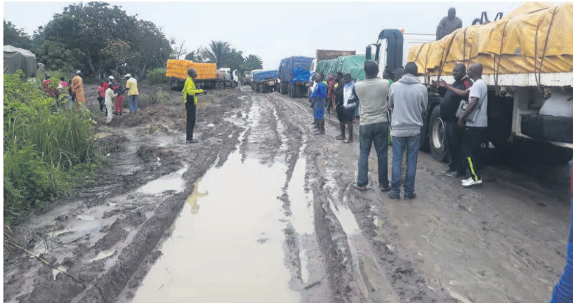
L'état de dégradation de la nationale 2/Adiac
