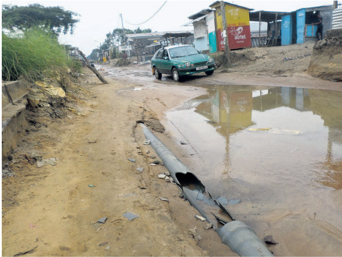
Le conduit a cédé au niveau de l'arrêt Momboti/Adiac
