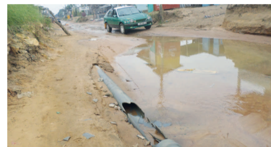
Le conduit a cédé au niveau de l'arrêt Momboti ; l'avenue principale ce 3 octobre en matinée Adiac
