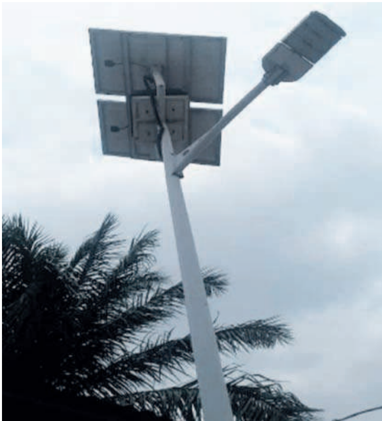
Un lampadaire solaire défectueux sur l'avenue «Dalettes»(Talangai)/Adiac
