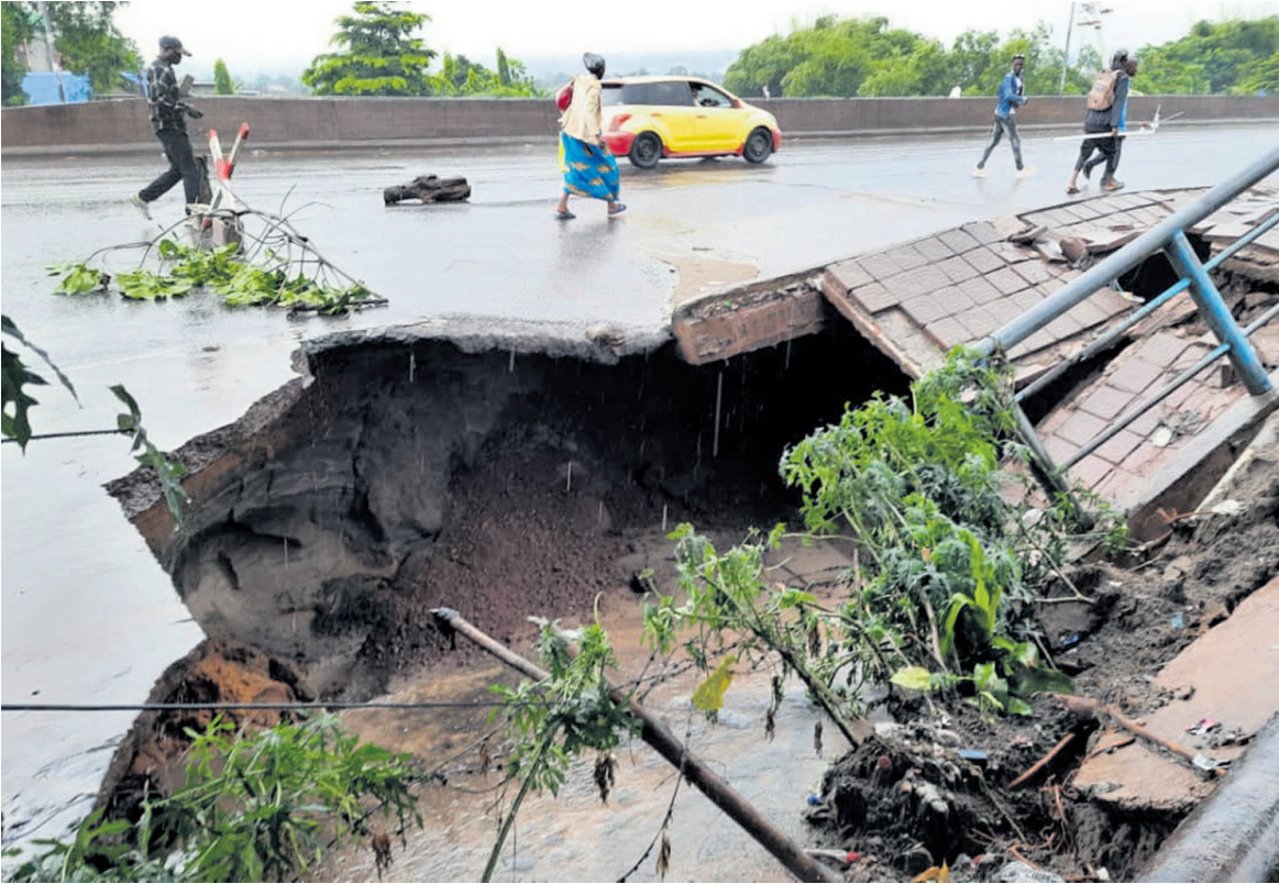
Le pont sur la rivière N’djili se détruit
