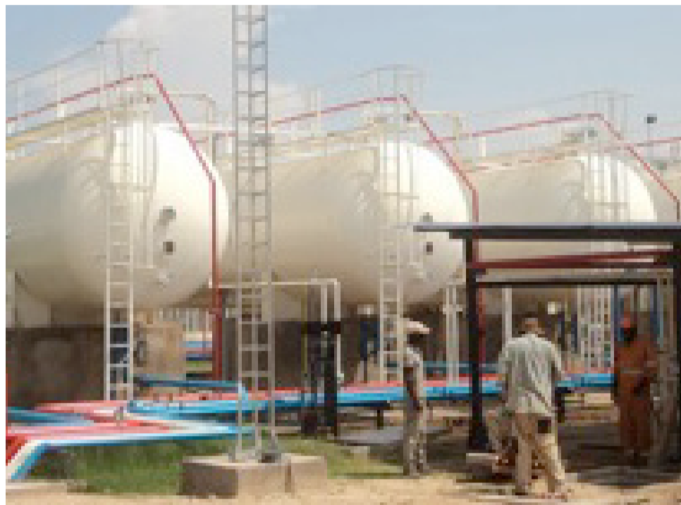
Installation de stockage d'hydrocarbures
