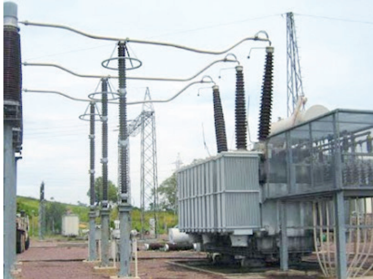
Un transformateur de la Snél dans un quartier de Kinshasa
