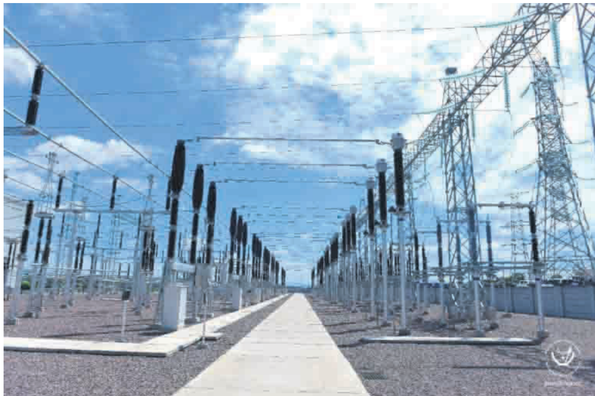
Des installations de la Snél SA
