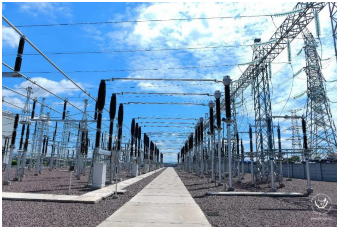
Des installations de la Snél SA
