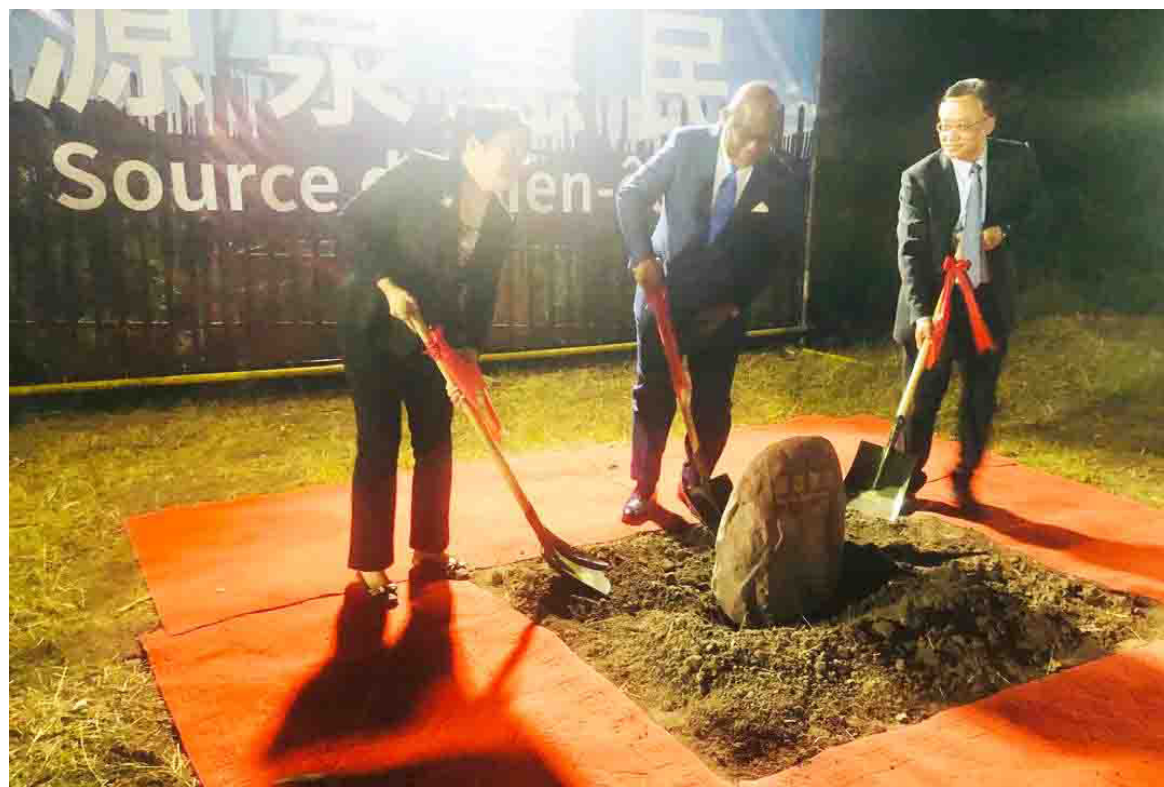
Lancement des travaux par le ministre, le représentant du gouvernement chinois et l'ambassadeur de Chine au Congo/DR
