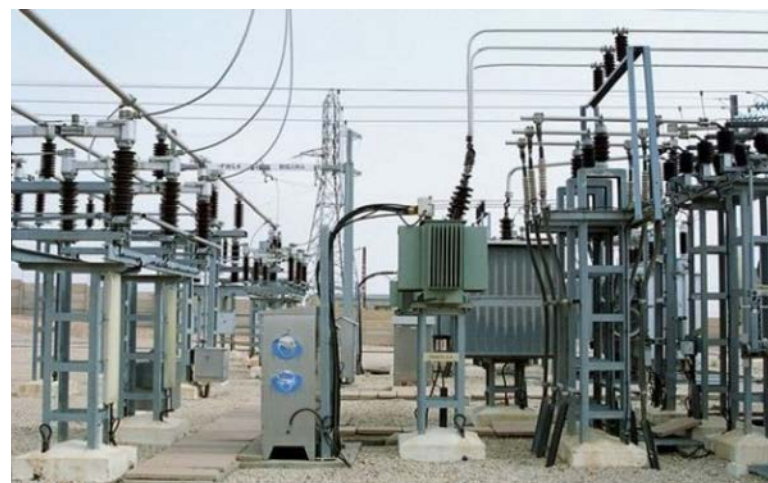
L'une des installations électriques de l'E2C/DR
